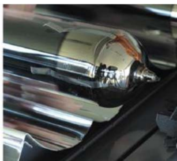
газопоглотитель в порядке, трубка исправная
